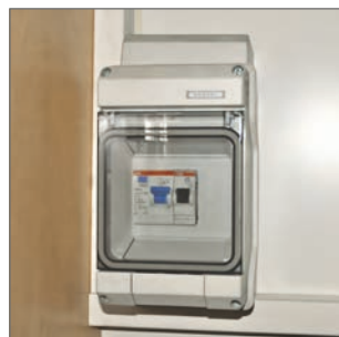
Verteilerkasten + FI + Sicherungen
